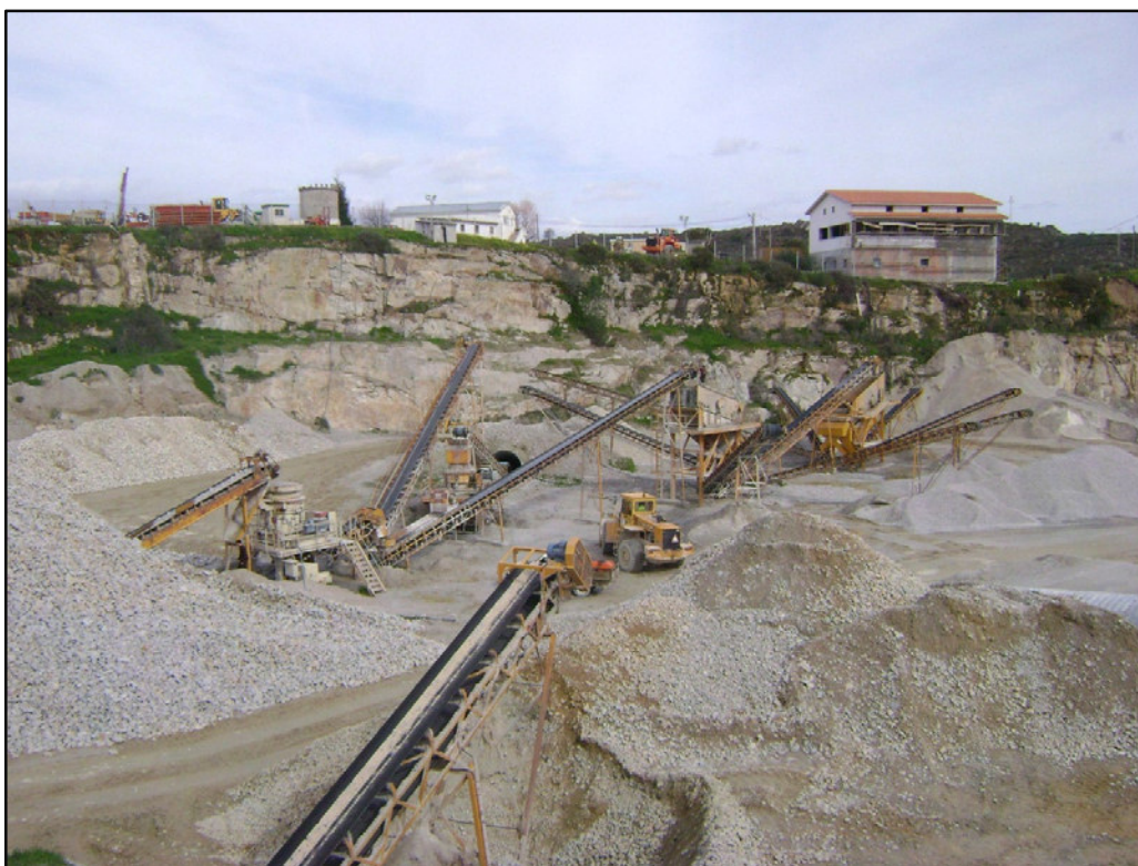
Fotografia nº 3: Vista parcial da instalação de britagem
